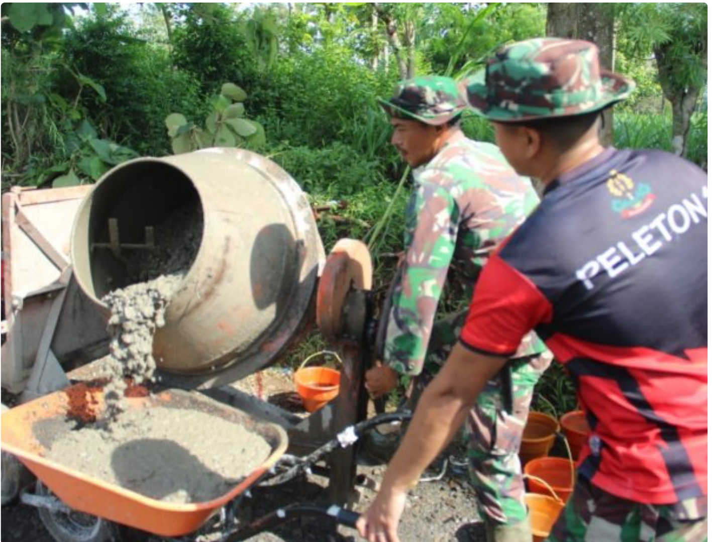
Foto : Betonisasi Jalan Program TMMD Reguler 119 di Desa Tanjungrejo, Kecamatan Margoyoso, Kabupaten Pati, Jawa Tengah, Minggu (25/2/2024).
